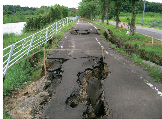
地震による堤防の変状・崩壊（印旛沼周辺）
