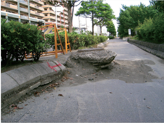
液状化によるマンホールの浮き上がり（浦安周辺）
