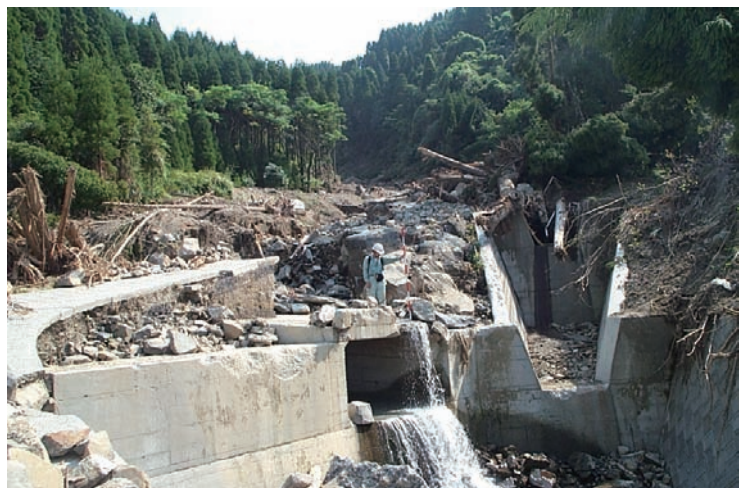
土石流による被災施設状況調査（2005年鹿児島県垂水市）
