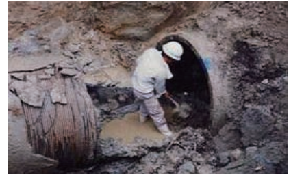
PC 管の破裂状況 (独)水資源機構群馬用水 HP より
