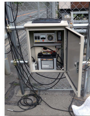
バッテリー内部の状況
