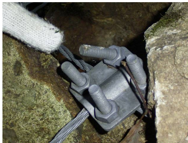
図8 クリップ部材の破損
