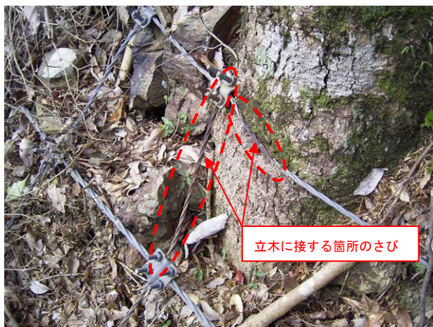
図6 立木に接する箇所のさび
